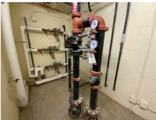
29 - FIRE SPRINKLER RISERS ANNEX
