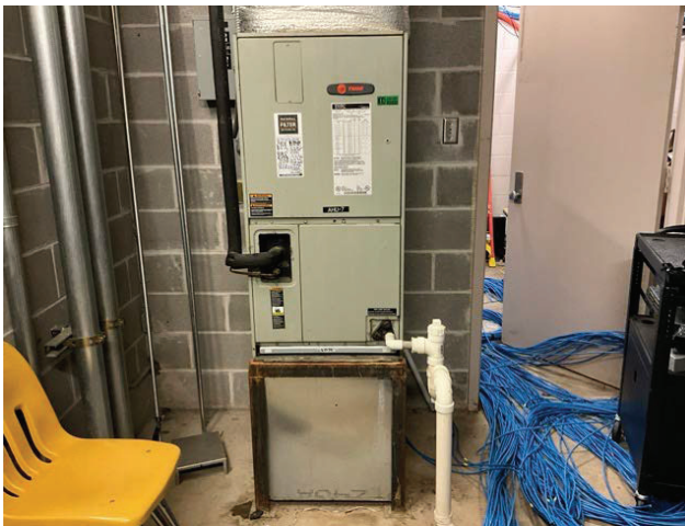
33 - FAN COIL UNIT
