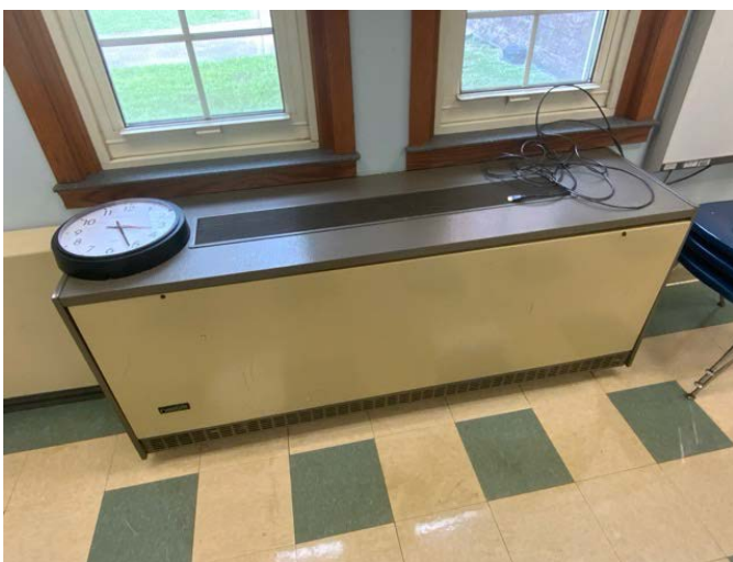
35 - FAN COIL UNIT
