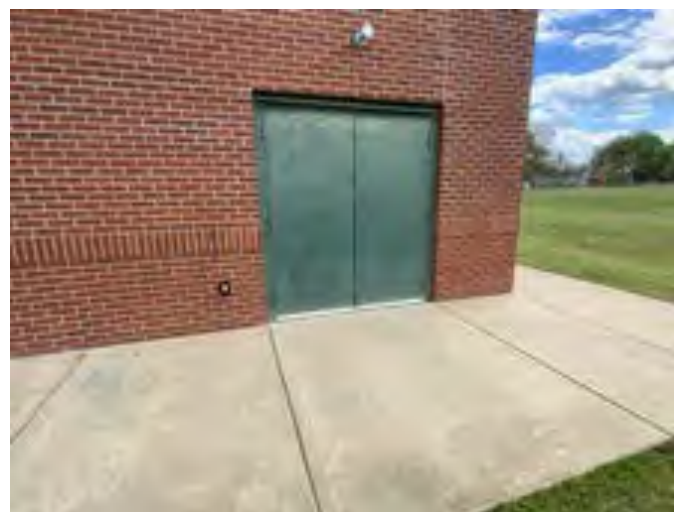
12 - EXTERIOR STEEL DOOR
